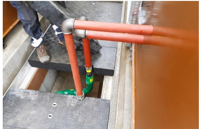
احتاجت بعض الأغطية إلى فتحات لاستيعاب شبكة أنابيب توصيل تمر من داخل الخندق إلى الشبكات الموجودة فوق الأرض
