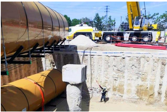
لغرض توصيل خزانات الوقود بنقطة التعبئة البعيدة، تم تركيب أنابيب KPS بقطر 4 بوصة (110/125 ملليمتر) موصلة كهربائياً.
