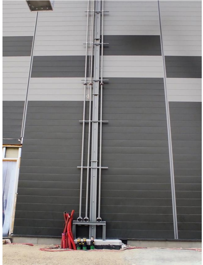
استُخدمت أنابيب توصيل من KPS بقطر 2 بوصة (63/75 ملم) ذات جدار مزدوج لتوصيل خزانات الوقود بأنابيب معدنية مركبة على الجدار الخارجي للمنشأة
